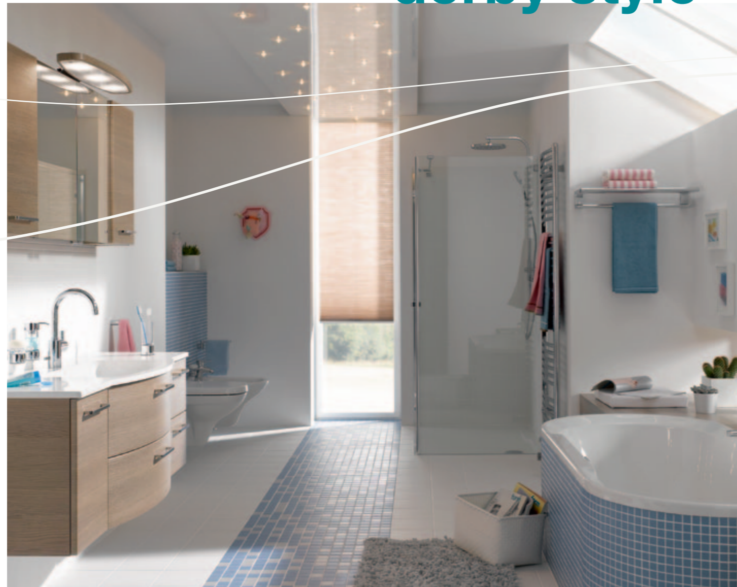
Duschsystem: Firma Nikles · Badheizkörper: Firma COSMO
